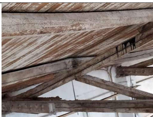
Прогибы несущих конструкций крыши (вид со стороны здания).
