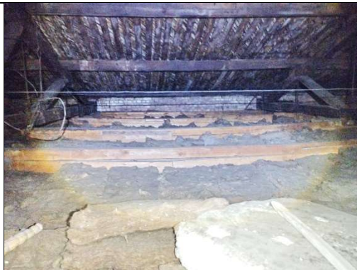
Значительные прогибы балок чердачного перекрытия.
