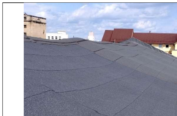
Прогибы несущих конструкций крыши (вид со стороны кровли).
