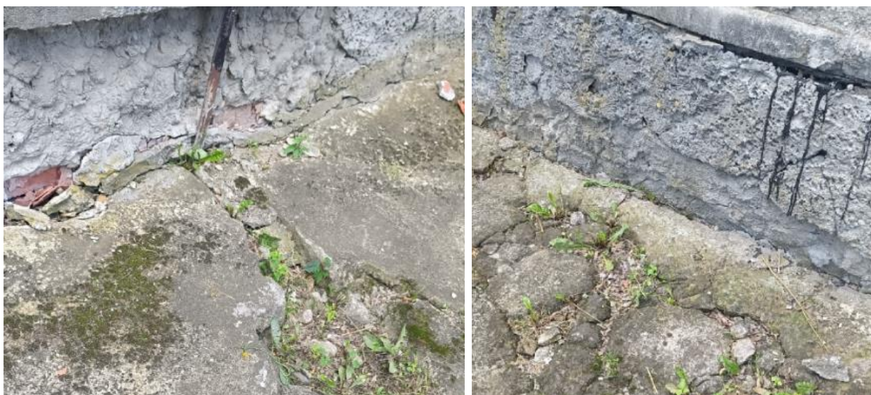
Фото 2.1.6. Дефекты отмостки и цоколя
