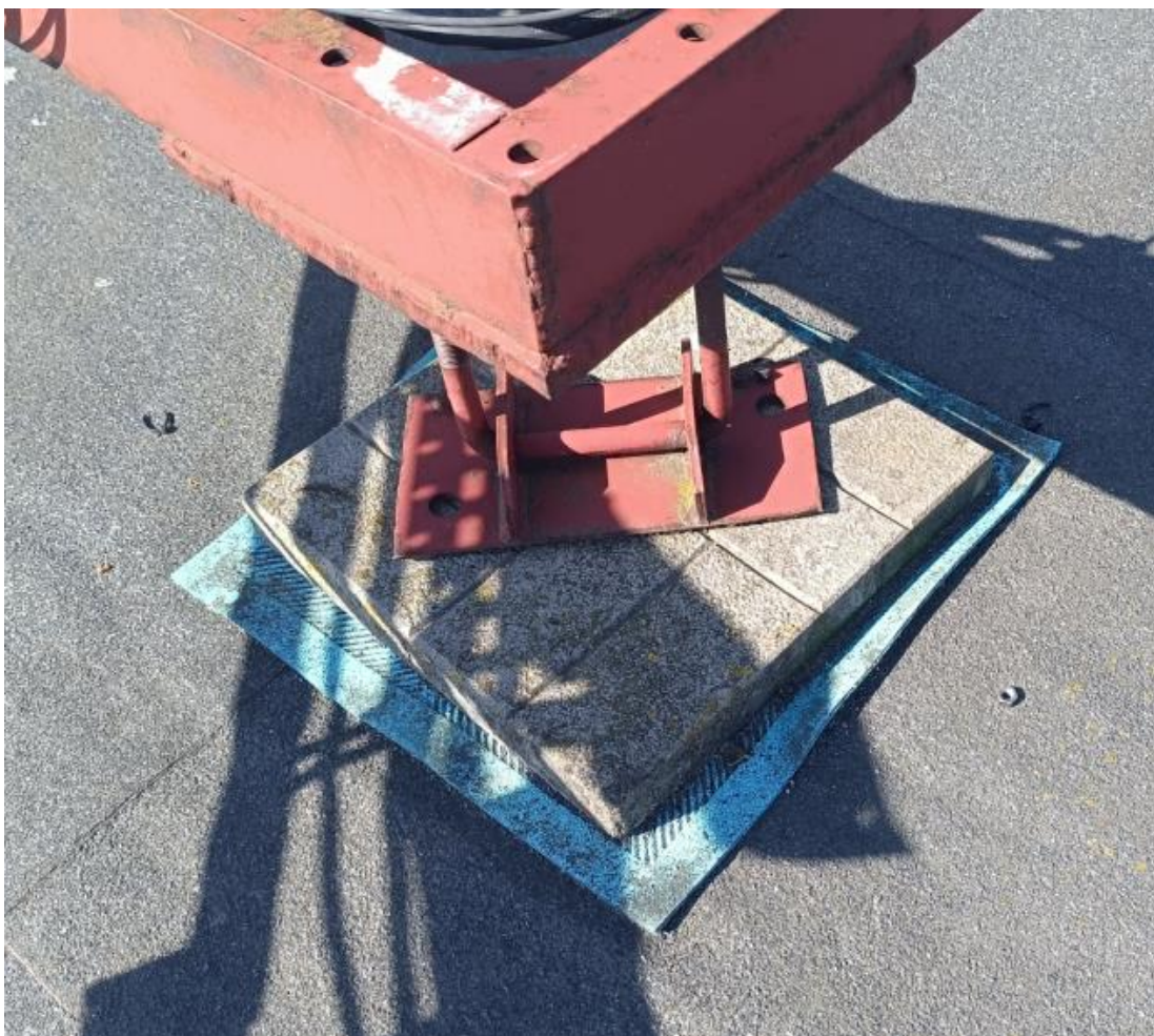
Фото 2.5.5. Крепление конструкций сотовой связи к кровле
