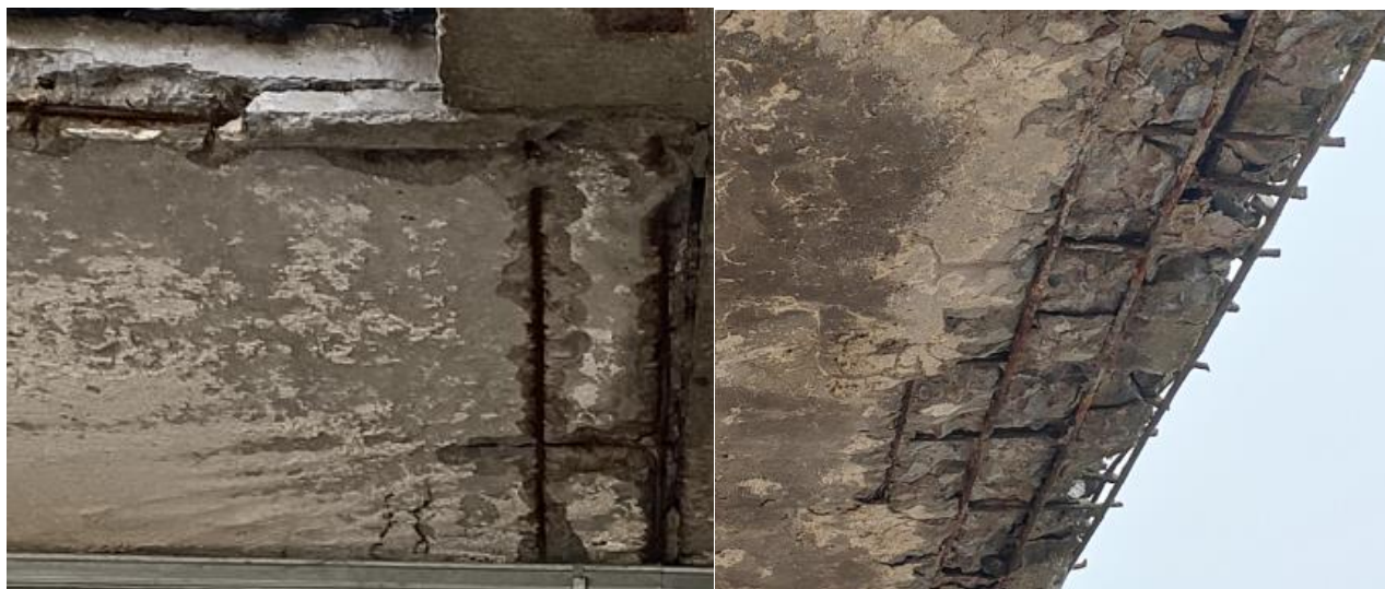
Фото 2.7.1. Дефекты балконных плит
