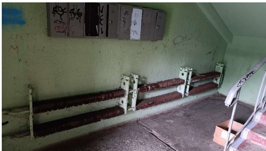
Рис. 7. Радиаторы отопления на стене лестничной клетки
