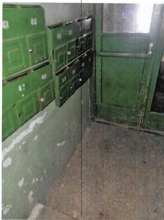
Фото 5. Почтовые ящики на лестничной площадке
