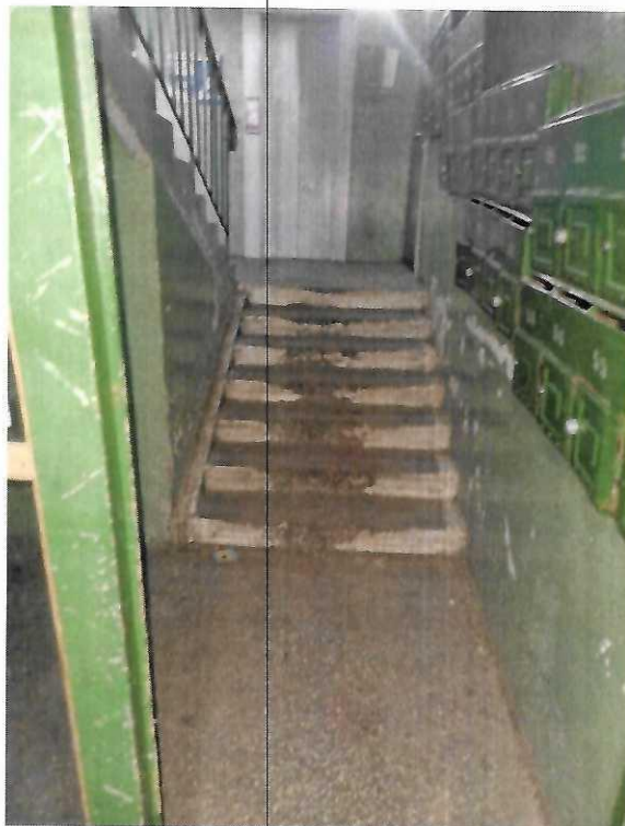
Фото 7. Состояние отделки тамбура
