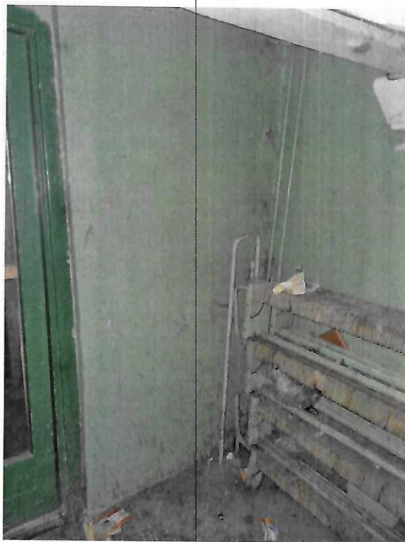
Фото 4. Отопительные приборы на лестничной площадке
